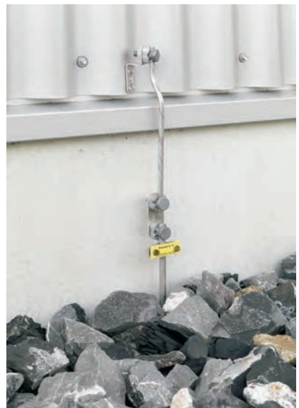
Isoleringsställe/mät punkt i jordningssystem
