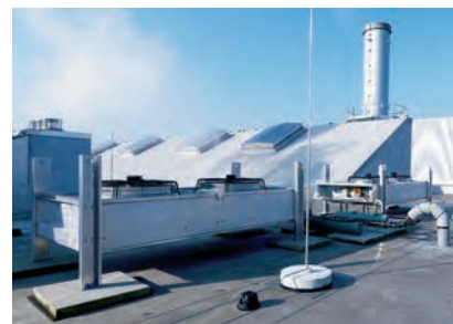
Isolerat åskskydd på takinstallationer
