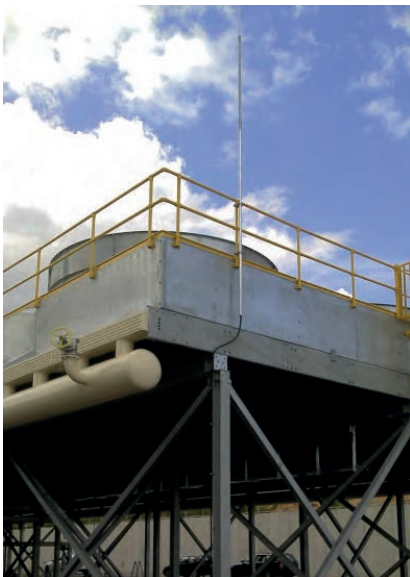
Isolerat avledningssystem i område med explosionsrisk
